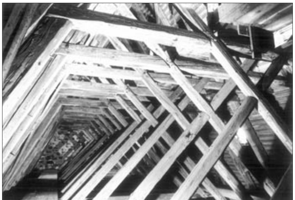
Bild rechts: Blick in den oberen Teil des Dachwerks der Klosterkirche in Pirna, Blickrichtung West. Foto: Johann Kluvetasch
